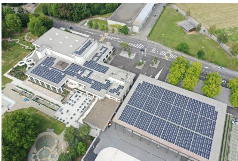
Abbildung 11: Photovoltaik-Anlage auf dem Dach
